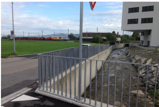
Abbildung 1 Geländerfüllung hat Palisadenwirkung
