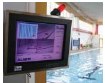
Auf dem Monitor erfolgt ein Alarm, wenn die Unterwasserkamera eine reglose Person auf dem Bassinboden entdeckt hat.
