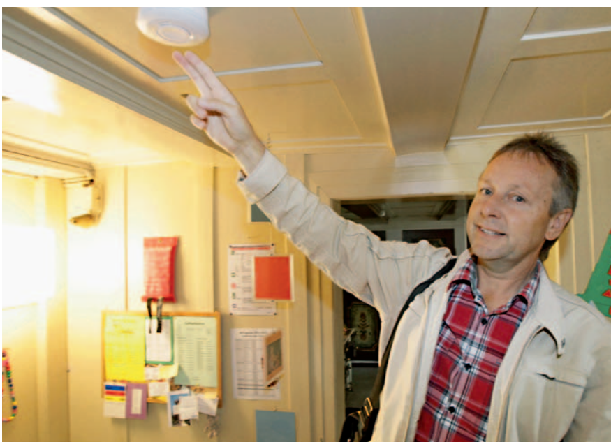
Per la scuola dell'infanzia provvisoria il delegato upi alla sicurezza Josef Bühler ha stilato un concetto di sicurezza nel quale non poteva mancare l'impianto antincendio.
